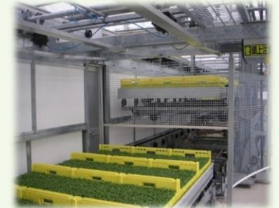
搬送エレベーター 2階栽培エリアにベンチを搬送
